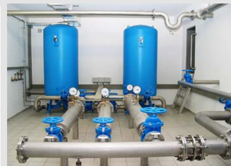
Installationen zur Druckerhöhung
